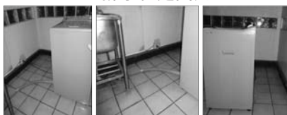
• 排水管並未固定
